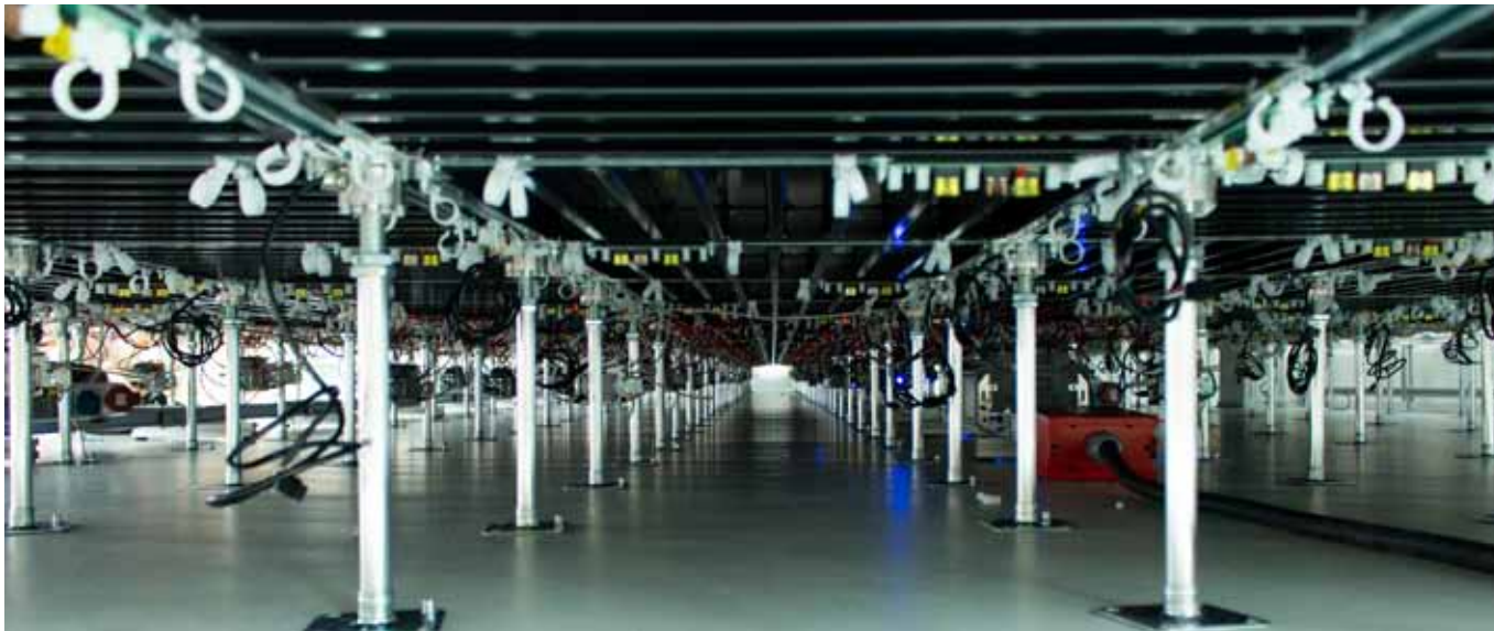
Blick unter den Fußboden: Das Versorgungsnetzwerk stellt Daten, Energie und Messtechnik bereit. Foto: Anne Bornkessel, IFF
