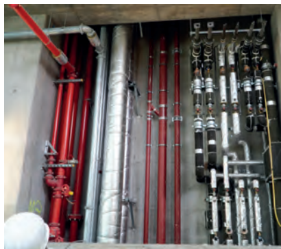
Versorgungsschacht im Erdgeschoss. Bild: Hans-Wilhelm Berghoff
