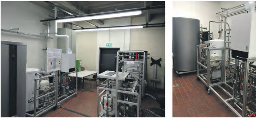
Bild 3: Ansichten des Thermischen Prüfstands für die Wärmeerzeugung. Bild: Le, Anisits, Scheunemann, entnommen aus [1]
