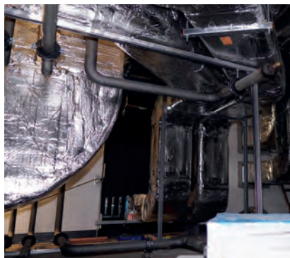
Lüftungszentrale im Untergeschoss. Bild: Hans-Wilhelm Berghoff
